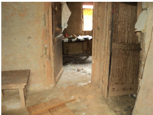
Porte et fenêtre endommagée
