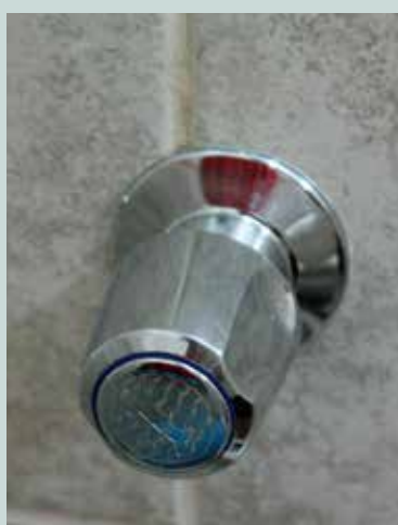
Instalaciones de agua
