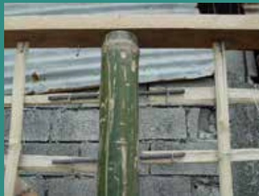
Anclajes pasantes en cañas ubicadas en parte intermedia de la pared
